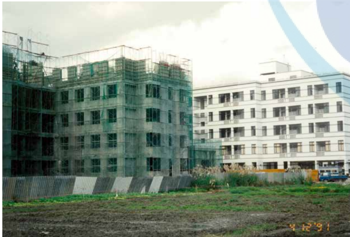
白色建築物即「延英樓」。圖左施工中之建築物為學生第二宿舍。(摘自本校第一輯校史)
