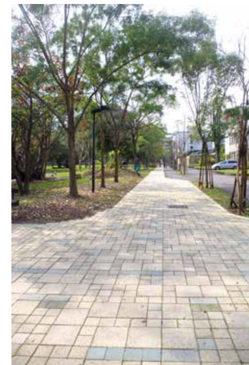
民國 107 年 8 月加設人工步道，改善北大路道路及人行空間約 200 公尺，鋪面更新高壓透水磚及景觀、植栽等。
