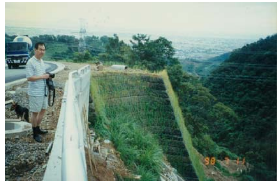
圖 16 佛光大學加勁擋土結構現況圖
